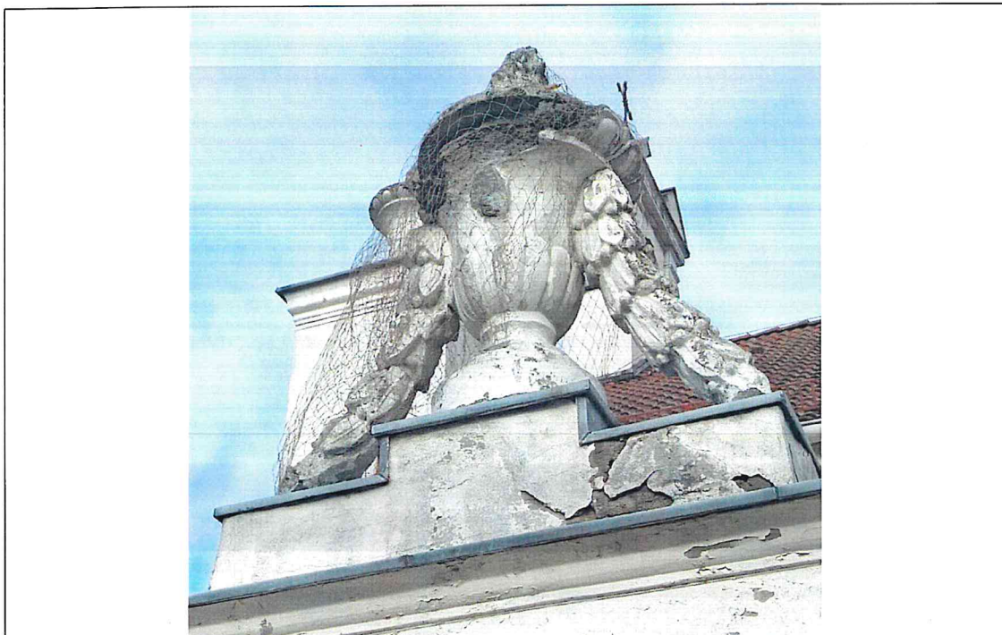
Fot. 3. Liczne uszkodzenia, rozpad bryły rzeźby
