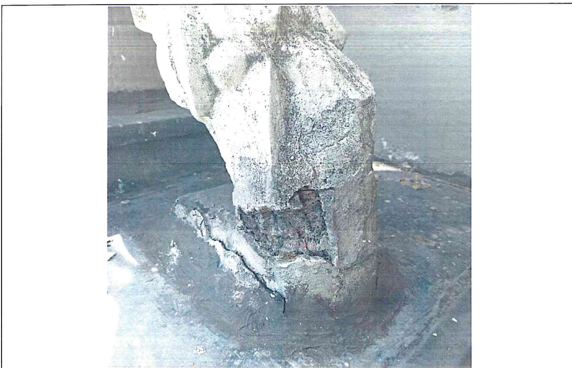
Fot. 7. Rozpad, osypywanie się powierzchni
