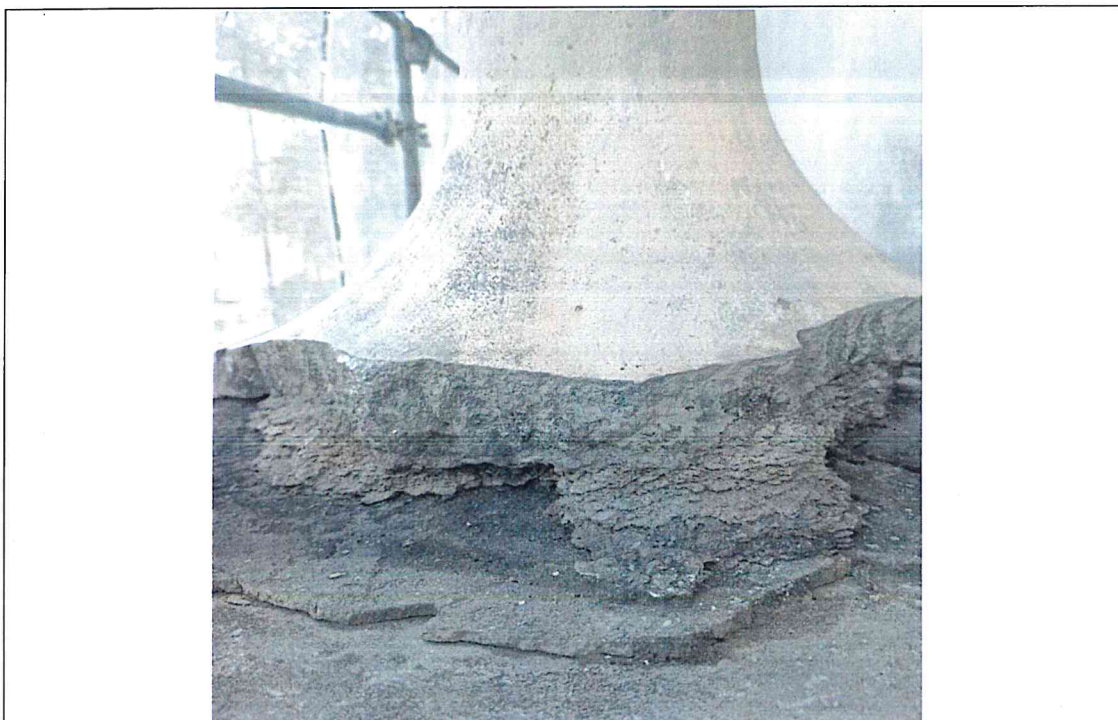
Fot. 6. Silna dezintegracja sztucznego kamienia wskutek wmywania przez wodę z solami
