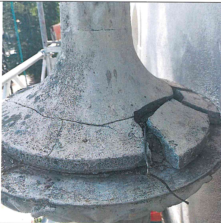
Fot. 5. Spękanie płaszczyzn i kruszenie się materiału
